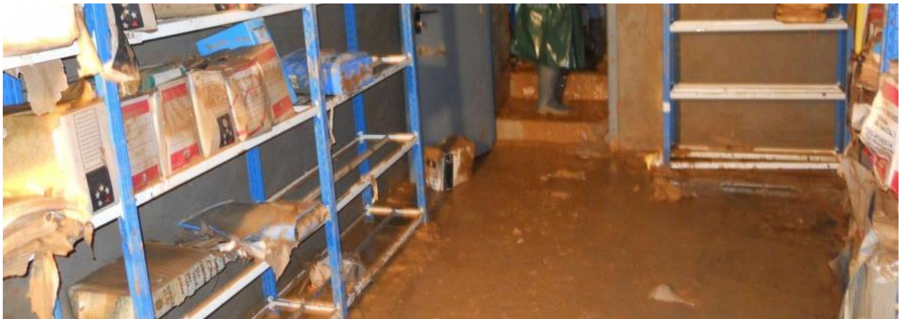
Dégâts causés par les inondations.
