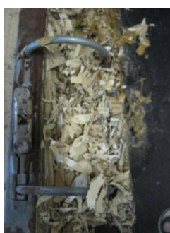
Dégâts causés par les rongeurs.
